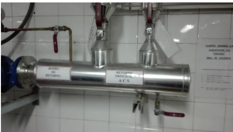
Figura 7A (arriba): Acumulador de Agua caliente sanitaria y pequeño depósito presurizado azul a su izquierda.
