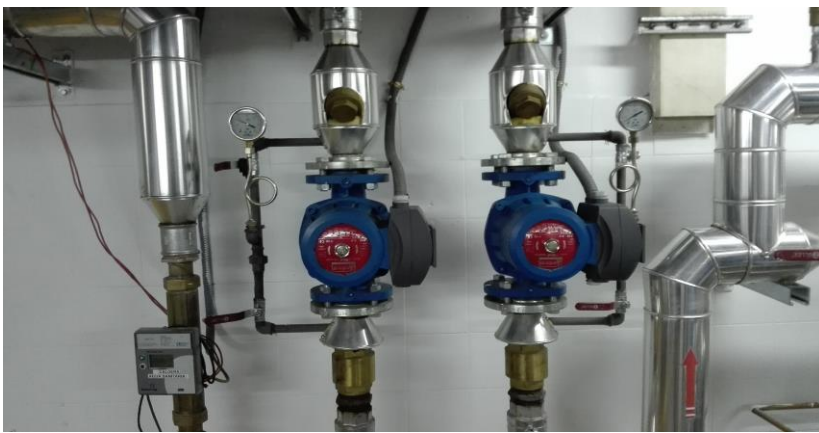
Figura 5: Bombas de impulsión en el circuito primario de agua caliente sanitaria.
