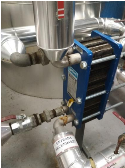
Figura 6: Intercambiador de placas donde se pueden apreciar la entrada del circuito secundario y salida del primario (parte inferior) y salida de agua del circuito secundario y entrada del primario (parte superior).
