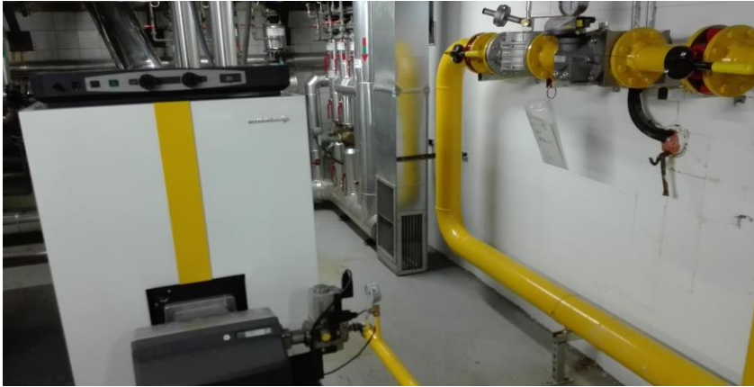
Figura 4: Caldera a gas para el circuito primario de agua caliente sanitaria.
