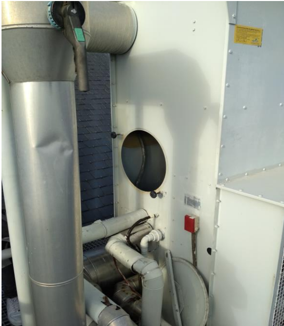
Figura 1: Vista lateral de la torre de refrigeración. Se aprecian la entrada y salida de agua, la boca de hombre, el rebosadero, tubería de vaciado y la válvula inyectora de biocida/anticorrosivo.
