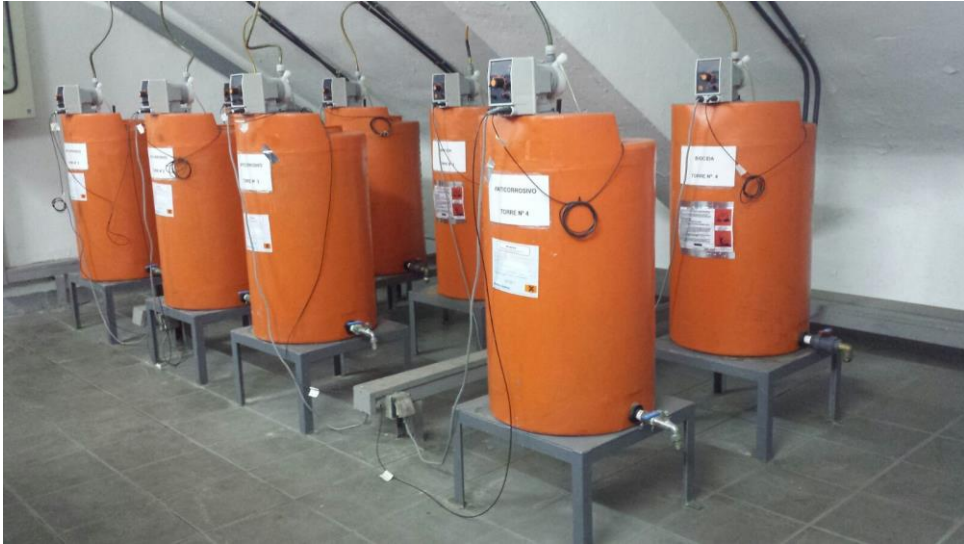
Figura 8: Sala de los biocidas y anticorrosivos, que irán a parar al interior de la torre de refrigeración.
