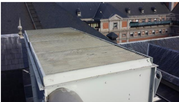
Figura 3: Vista desde arriba de la torre de refrigeración, donde se pueden observar los separadores de gotas.
