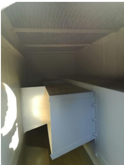
Figura 2: Vista del interior de la torre de refrigeración desde el registro o boca de hombre. Se puede observar abajo el agua de la balsa, y arriba el relleno.
