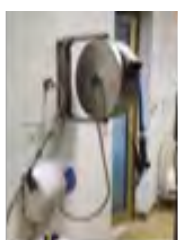
IMAGEN 5. MANGUERAS DE AGUA A PRESIÓN EN OBRADOR DE PANADERÍA Y REPOSTERÍA
